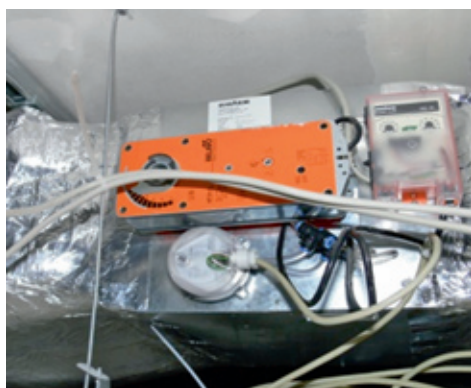
Abb. 5: Eine typische Luftmengen-Messeinrichtung in einem RLT-System
